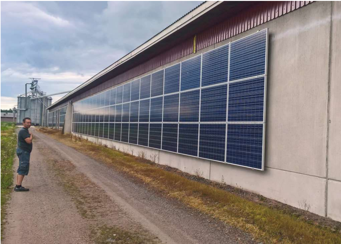
Kuva 4. Aurinkopaneelien seinäesennus (Finwind 2020a).
